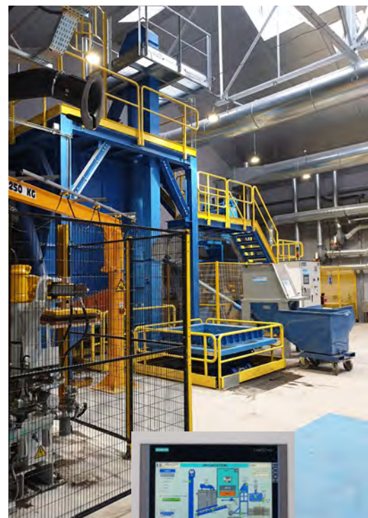
La sablerie et son armoire de commande
