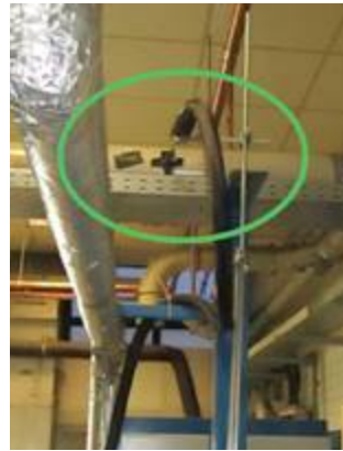
Figure 1 - FID capteur dans le conduit d'évacuation de la noyateuse
