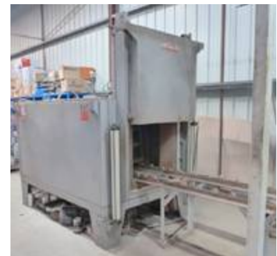
Four de traitement thermique
