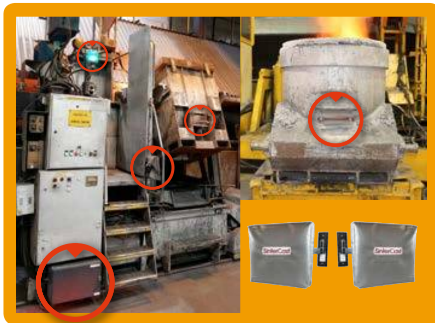
Fig 1. Position typique d'une installation « Ladle Tracker », montrant le tag RFID sur la poche, l'antenne et le lecteur RFID, un signal lumineux confirme que toutes les étapes du procédé ont été complétées avec succès.
