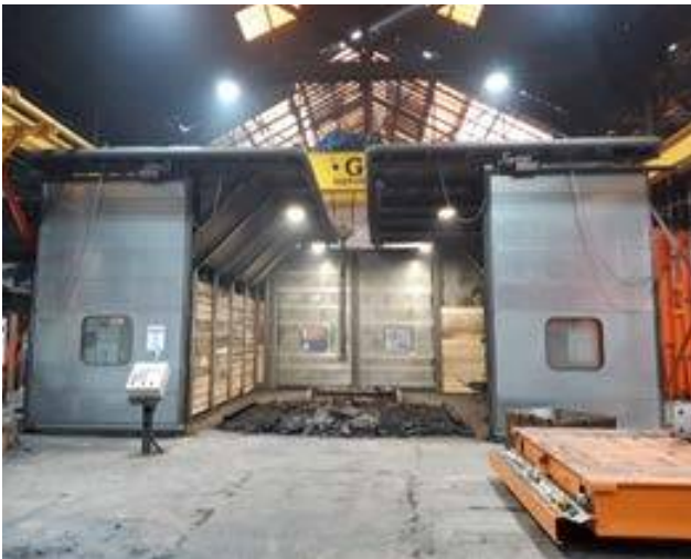
Photo 2 : Cabine à passage traversant
