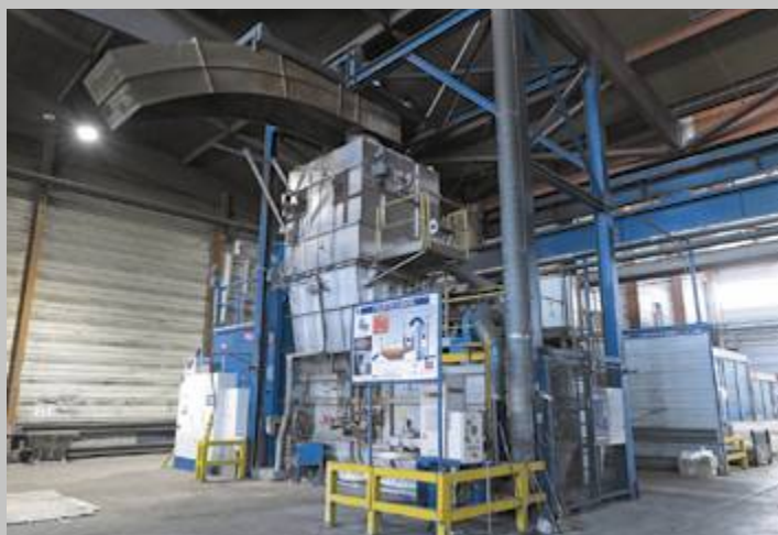
Four de fusion STRIKO MH2-T 6000/3000, de 2008, rétrofité en 2021
